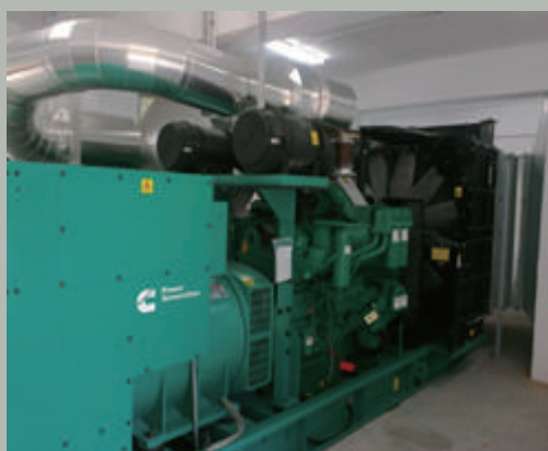
■ 1000kW發電機設備 1000kW generator
